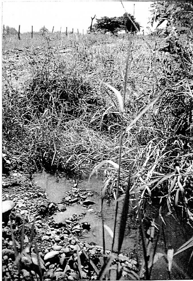
Foto 8. Km. 7+834 - margen derecha. Alcantarilla de 24" sin cabezales y totalmente colmatada.
