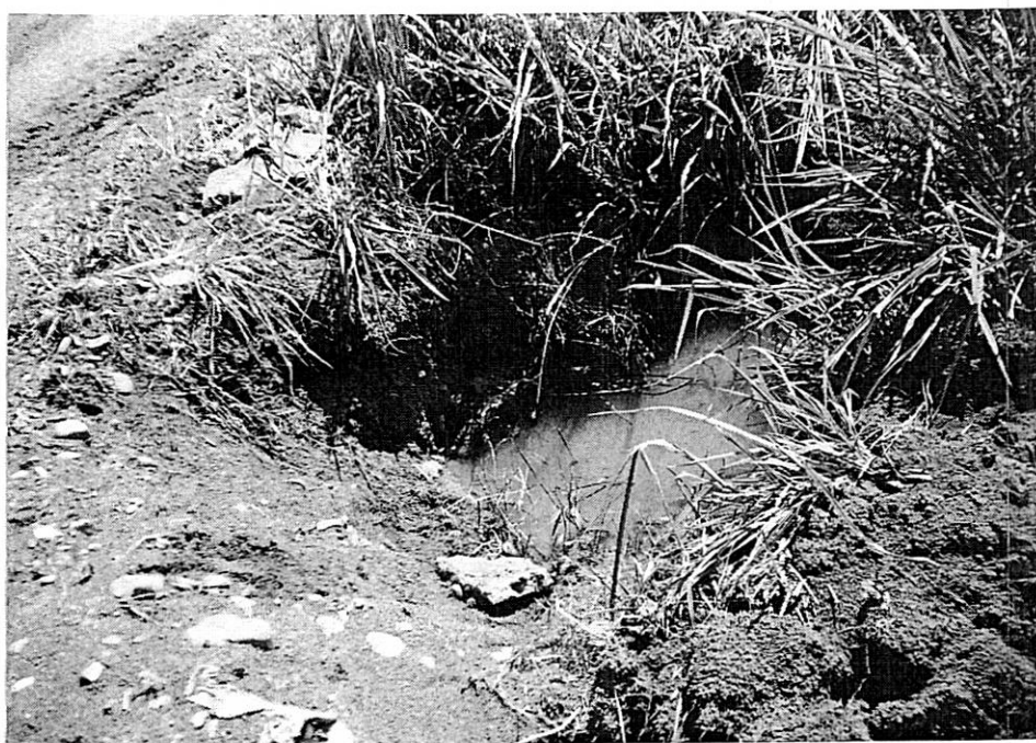
Foto 12. Km. 11+121. Alcantarilla totalmente obstruida.
