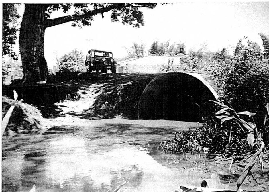
Foto 7. Km 6+986. Quebrada Cañitas. Paso de alcantarilla en regular esta
