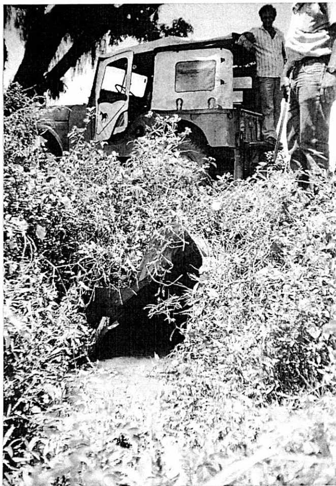
Foto 4. Km. 5+600 - margen derecha. Paso de alcantarilla con drenaje colmatado.
