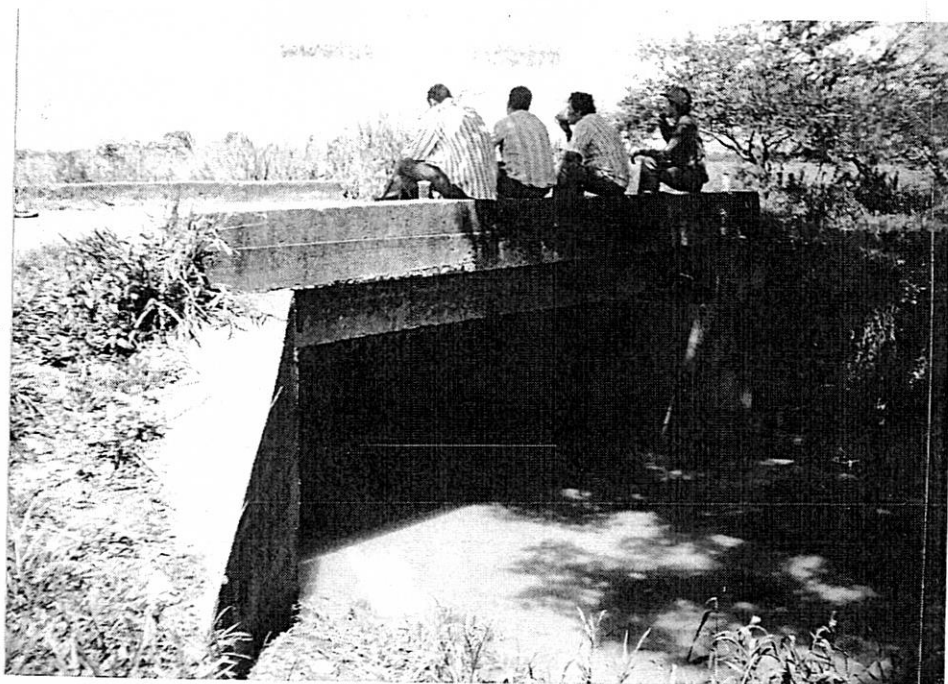
Foto 10. Km. 9+430. Zanjón la Carolina. Pontón en buen estado pero insuficiente para el proyecto.
