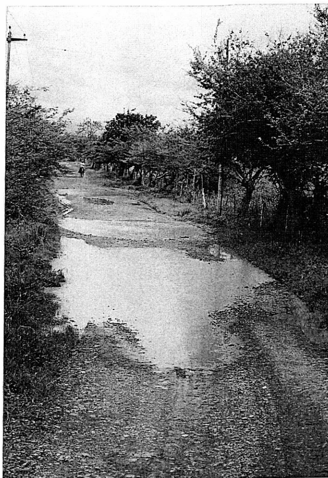
Foto 5. Km. 9+000. Carreteable en mal estado.
