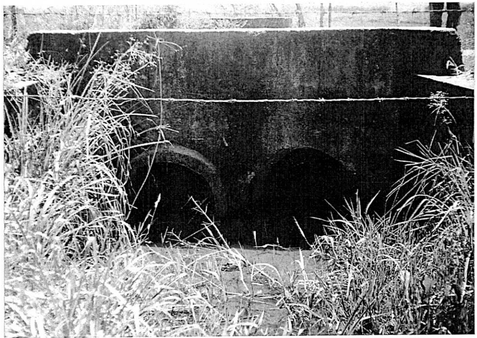
Foto 9. Km. 8+654 - margen izquierda. Doble alcantarilla sin mantenimiento.
