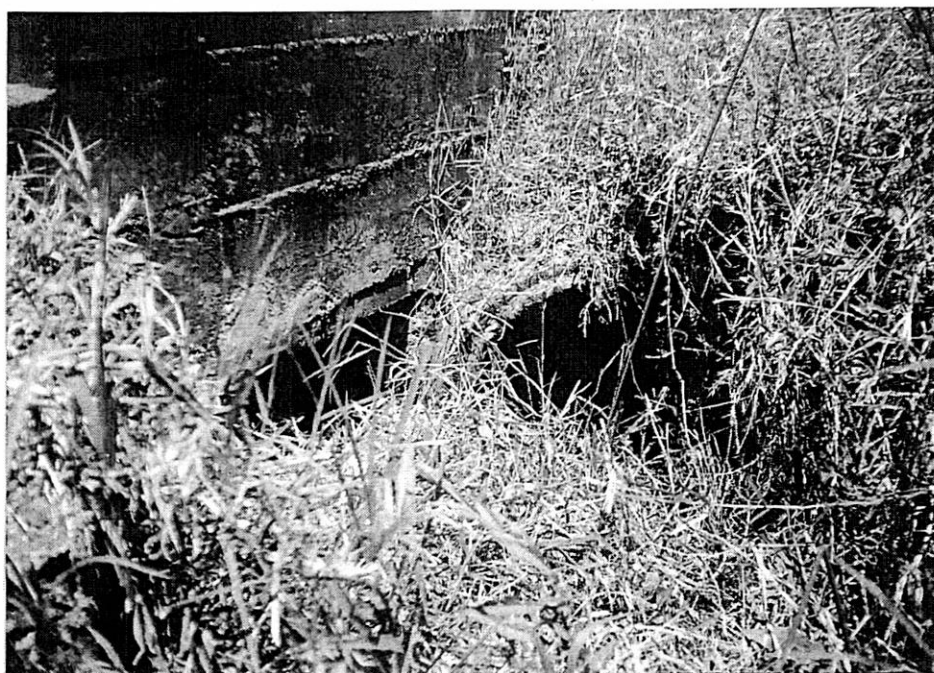
Foto 2. Km. 2+297 - margen derecha. Alcantarilla en total estado de abandono.
