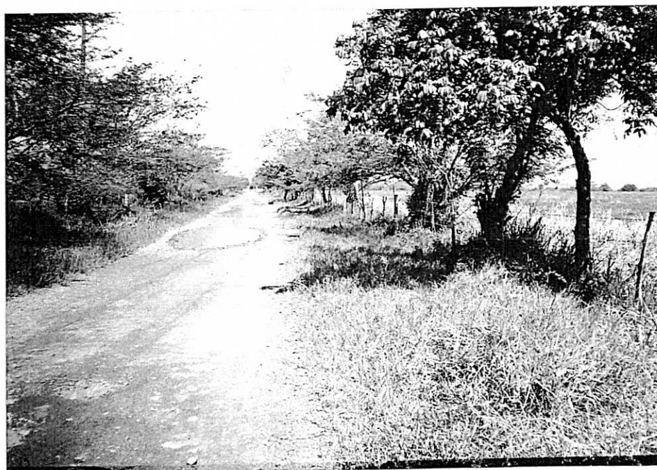
Foto 23. Km. 9+250. Encharcamiento de la vía por lavado de finos.
