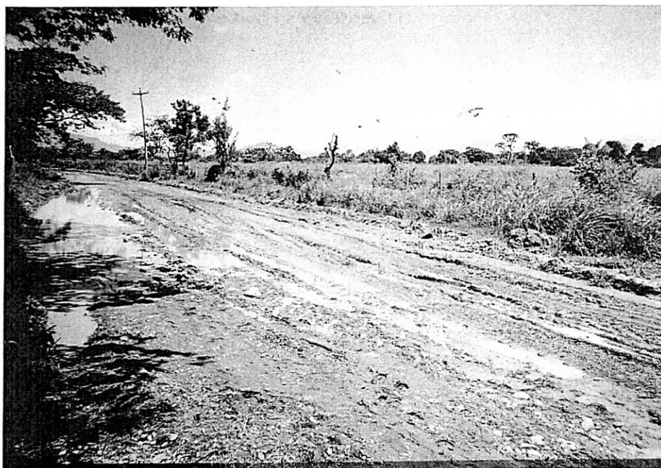
Foto 20. Km. 7+830. Encharcamiento de la vía y piso lodoso por presencia de suelos cohesivos.
