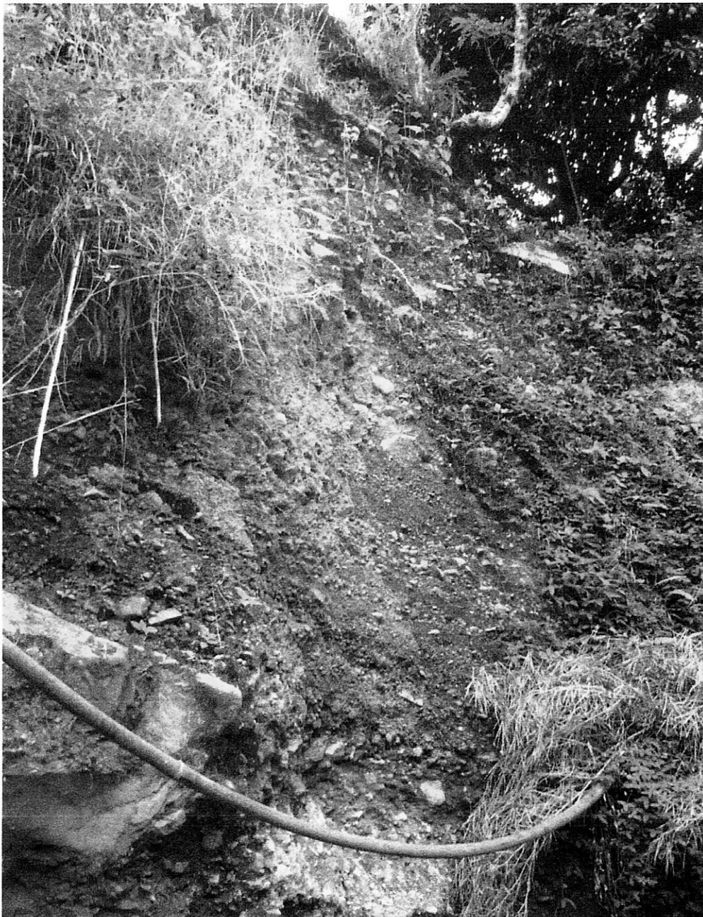
Tubería colapsada por socavación severa del suelo de soporte
