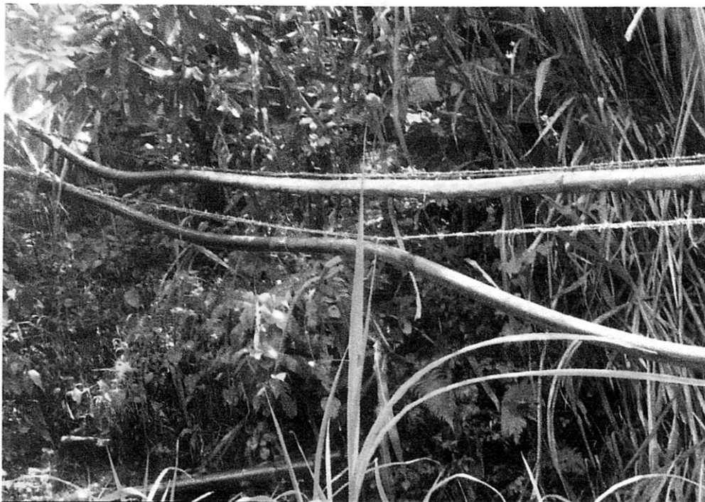
Cruce de quebrada, Conducción #3, tubería aérea
